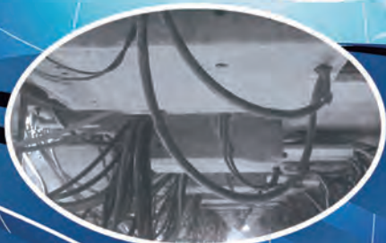
水冷式漏板池窑变压器
