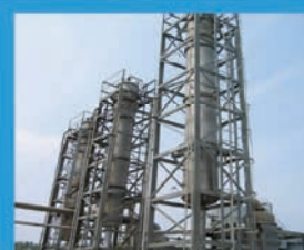
废水精馏塔组
