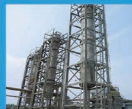
废水精馏塔组
